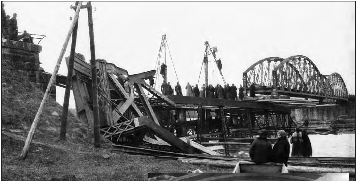
Zniszczony most kolejowy w Nowym Sączu
