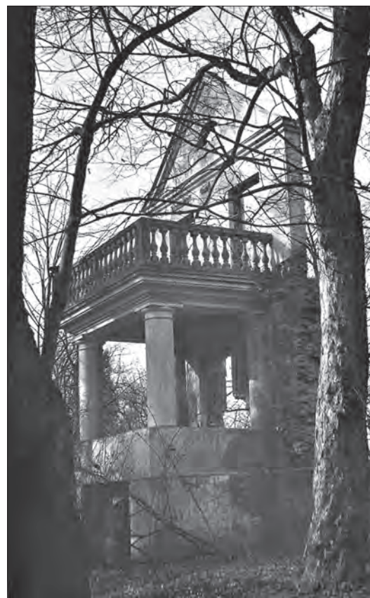
Resztki ganku z balustradą tralkową dworu w Mordarce.
