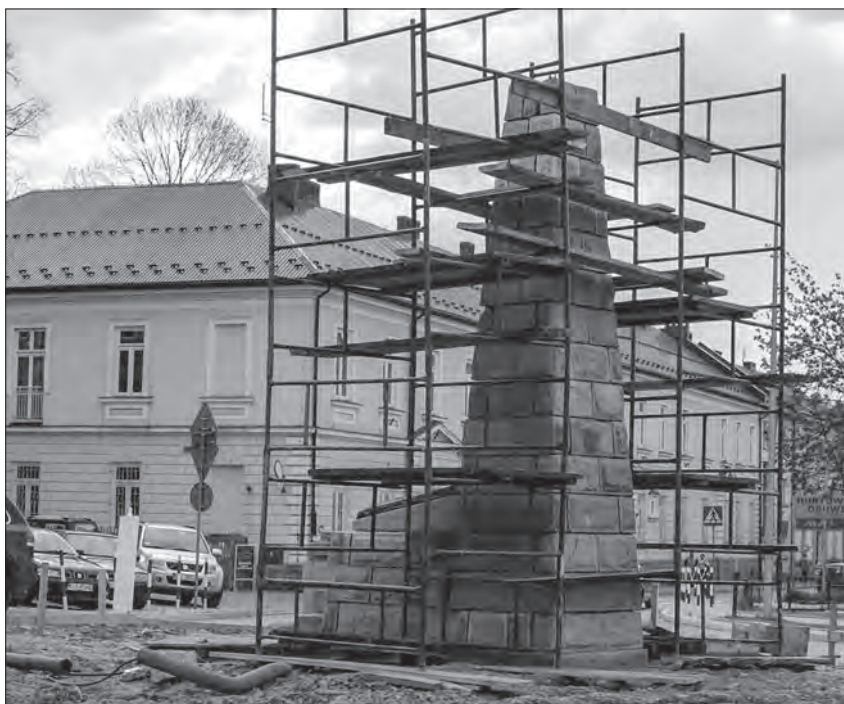
Budowa Pomnika Nieznanego Żołnierza na rondzie u zbiegu ulic.: M.B. Bolesnej, Moniuszki i Targowej - 24 kwietnia 2014 r.
