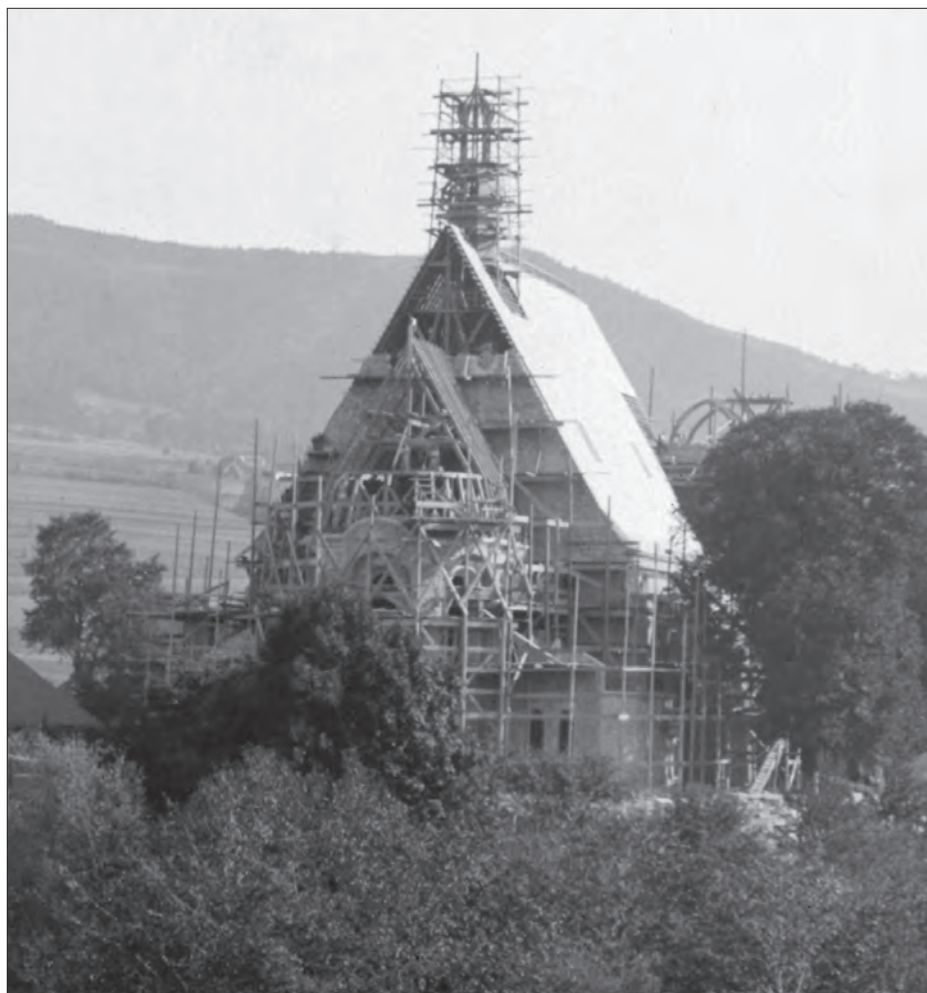
Widok od strony Potoku Starowiejskiego na budowany kościół limanowski: tuż po zakończeniu pracy przy więźbie dachowej nad prezbiterium - 1914 rok
