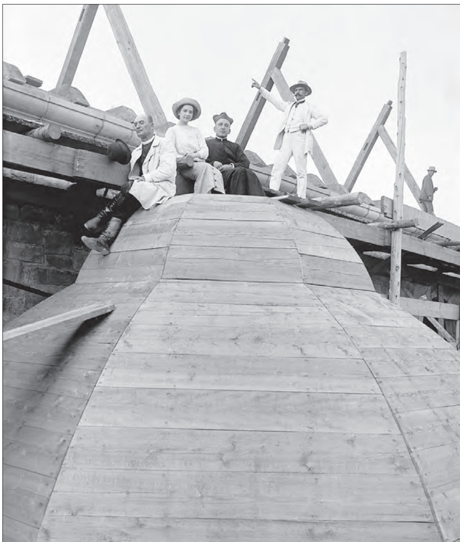
Na odeskowanej kopułce kaplicy (przygotowanej do pokrycia) siedzą od lewej: ks. Kazimierz Łazarski, Wiktoria Zubrzycka, ??, Jan Śmierciak. Rok 1912. Fot. arch. albumu „Okruchy pamięci. Limanowa na starej fotografii”
