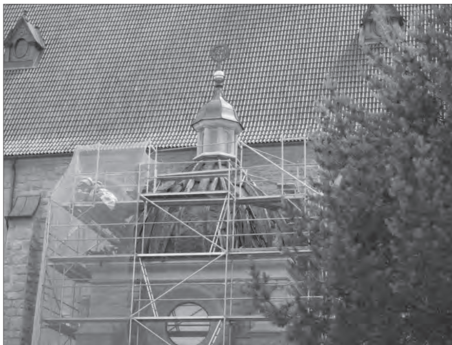
Zniszczony drewniany szkielet więzarów kopuły kaplicy św. Antoniego - lipiec 2017 r.
