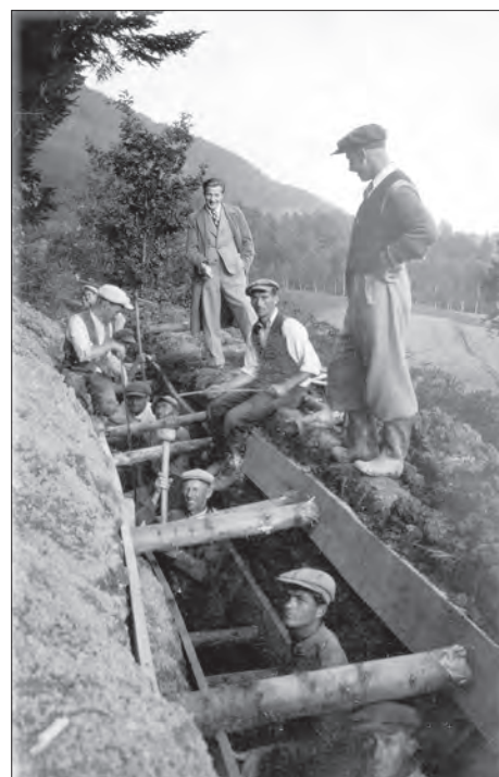
Powyżej: Wykopy pod wodociąg w okolicy miejskiego lasu (dzisiaj przy ul. Kasprowicza).
