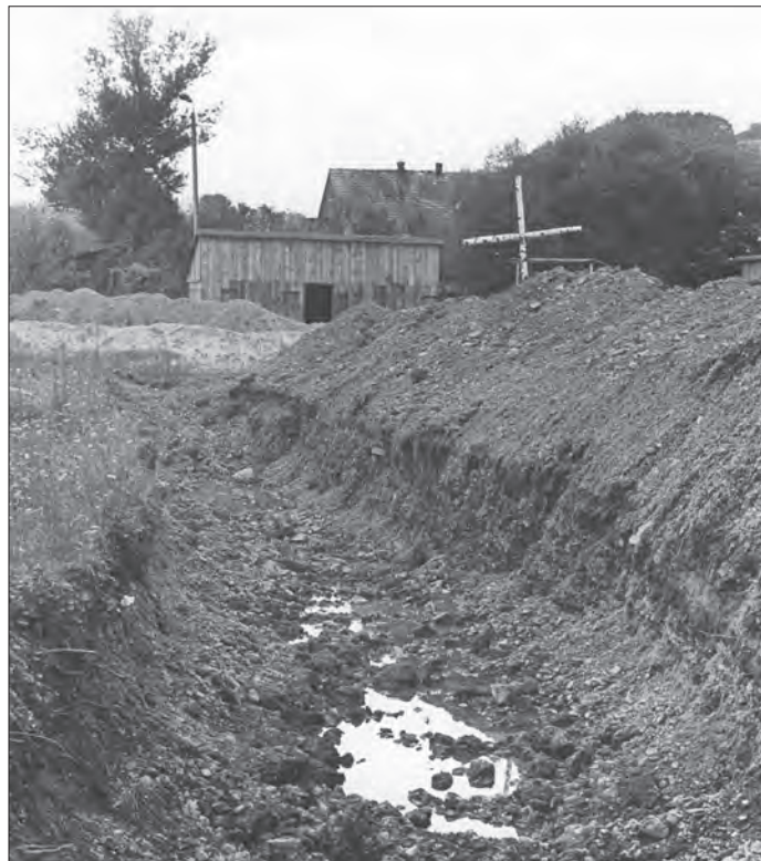
Wykopy ziemne pod stopy i ławy kościoła, którego budowę rozpoczęto w 1979 roku. [Fot. Józef Staniszewski]
