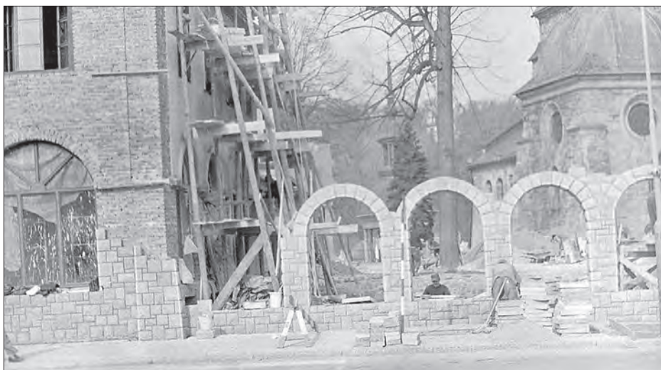
Budowa arkadowego kamiennego ogrodzenia od Rynku. [Fot. arch. parafii MB Bolesnej w Limanowej]
