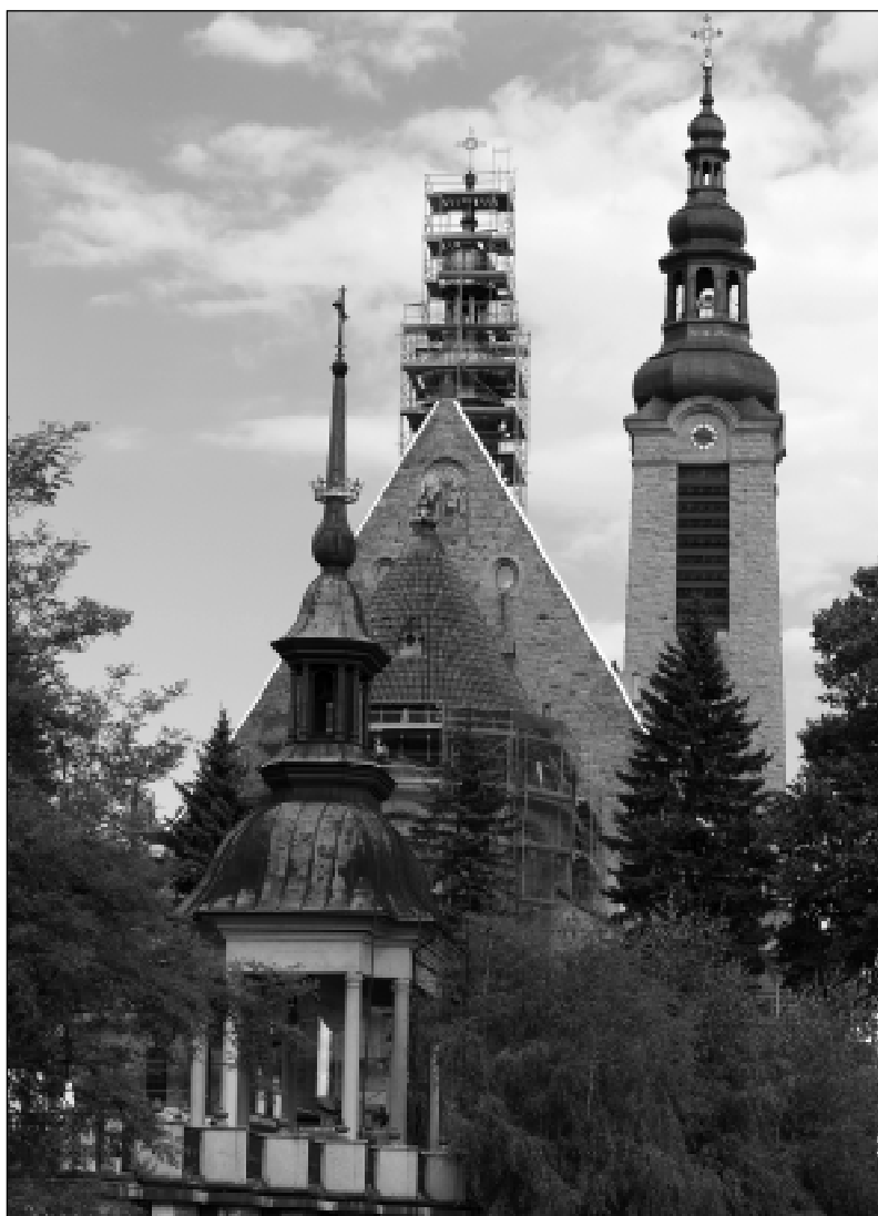
Okucia z blachy miedzianej widoczne na gzymsach od strony prezbiterium kościoła.
