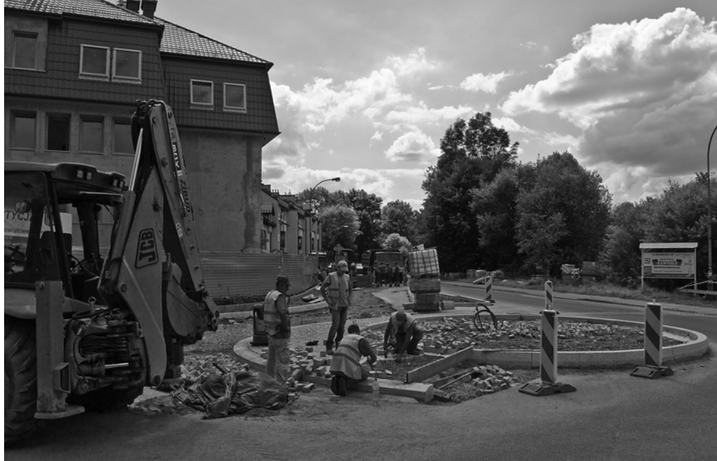
Powyżej: Budowa małego ronda na skrzyżowaniu ulic J. Marka, ks. Łazarzkiego i Grunwaldzkiej. Poniżej: Realizacja budowy krytej pływalni przy ul. Z. Augusta - budowa ław fundamentowych.
