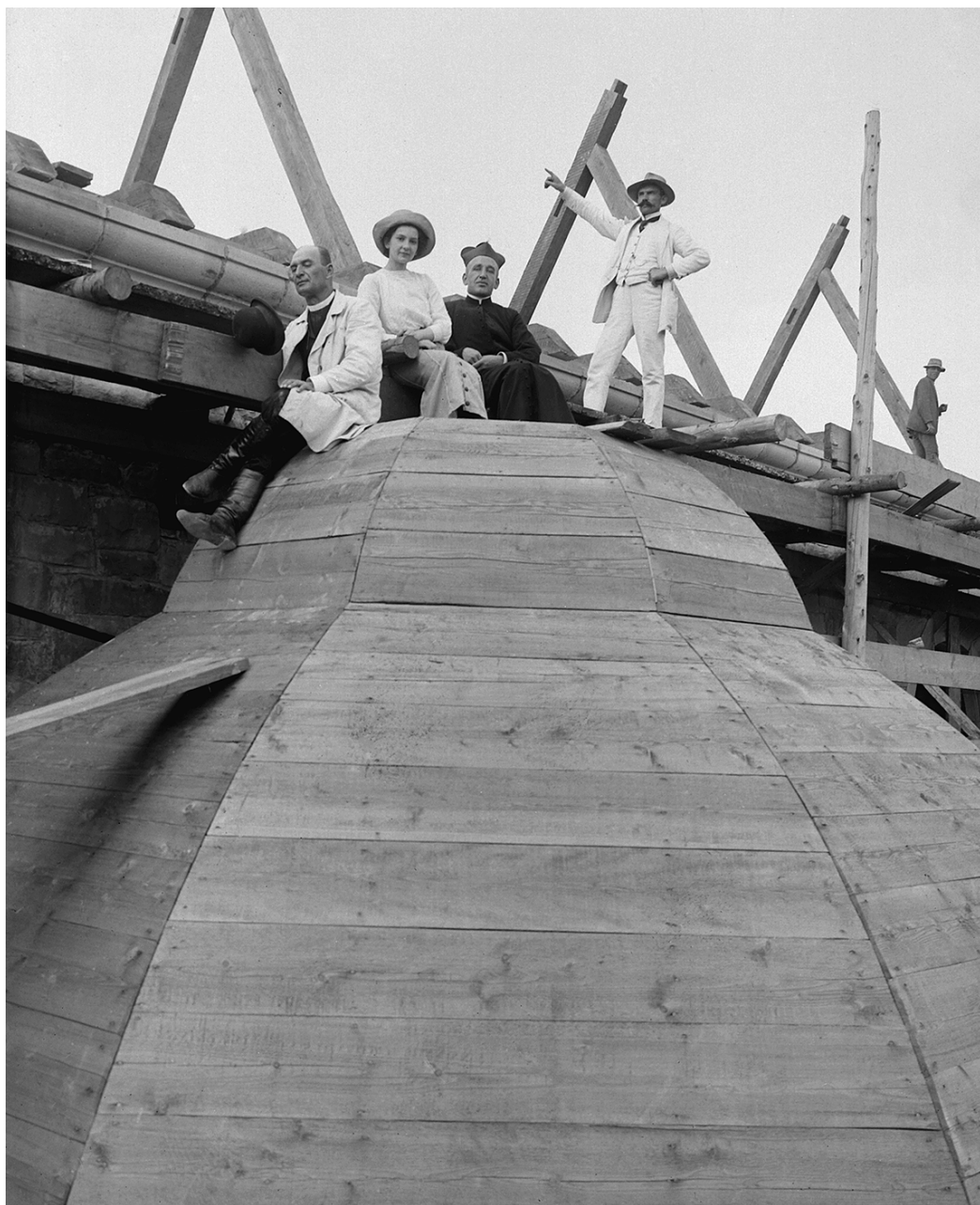
Na odeskowanej kopułce kaplicy (przygotowanej do pokrycia) siedzą od lewej: ks. Kazimierz Łazarski, Wiktoria Zubrzycka, ?, stoi kierownik budowy, nieco dalej - majster.
