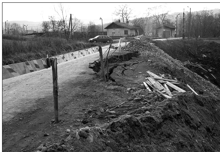
Jesienne deszcze uaktywniły osuwisko. Oberwał się znaczący pas przy ulicy Paderewskiego, jedynej drogi do Osiedla „Nad Torem”.
