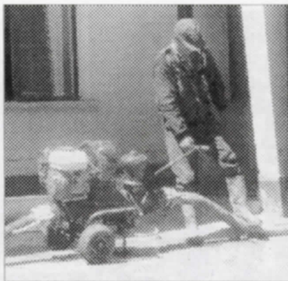
fol. Pompowanie wody z zalanych piwnic.
