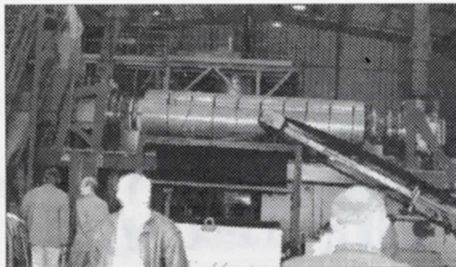
Komora prażenia odpadów
